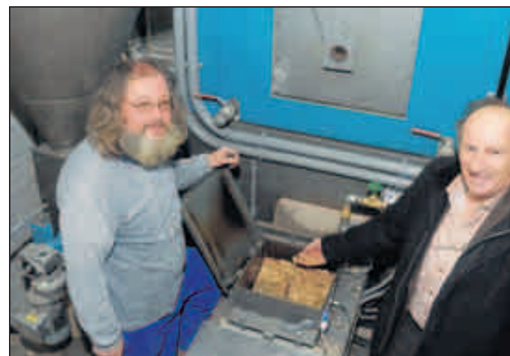
Isolierchef Alfons (l.) mit Heizungsboss Feichter im Kesselraum
